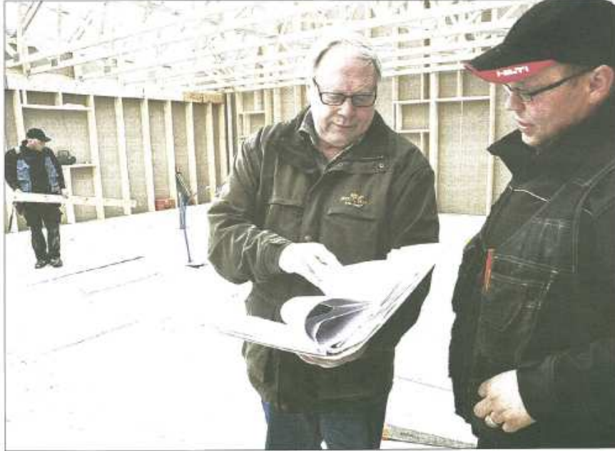
Martti Pakka ja Hartman Kodin asennusurakoitsija Mikko Kuivinen keskusteleval rakennussuunnitelmista. Kuivisen työparina työskentelee Kari Kallioväli.
